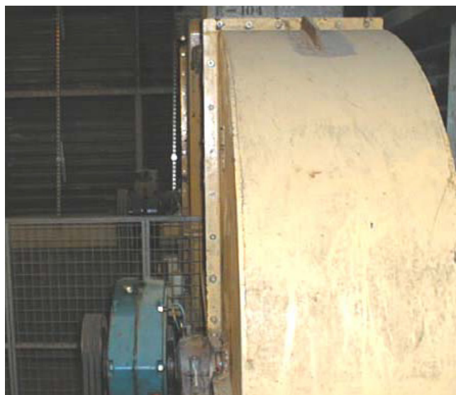
Elevatore principale in ingresso
