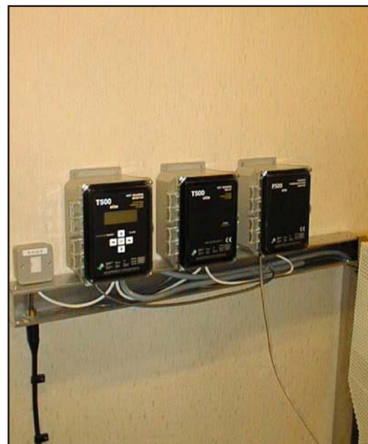
Il sistema HotBus™ 4B installato in una sala di controllo dello stabilimento
