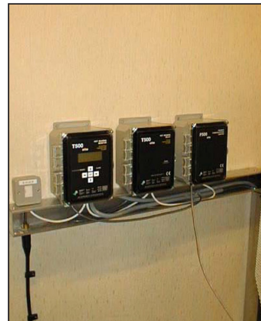
4B HotBus™-System, das in einem Anlagenkontrollraum installiert ist
